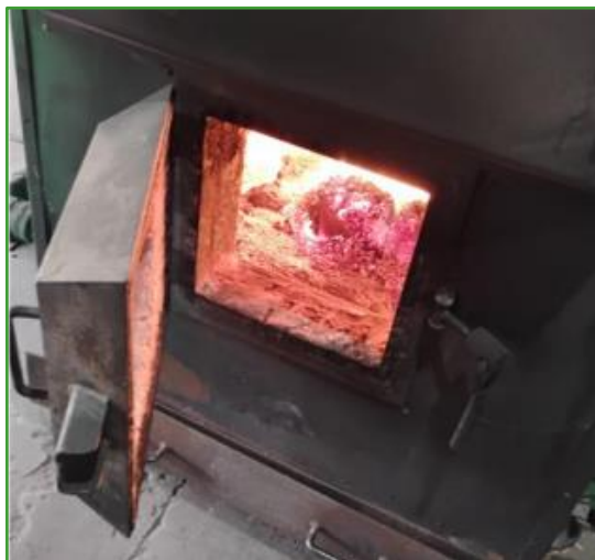
Figura 18 - Demonstra Acúmulo De Brasas E Resíduos Dificultando A Funcionalidade Adequada Da Caldeira
